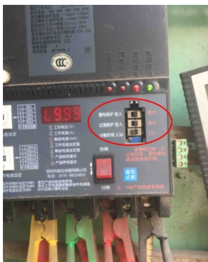
Figure 1. Leakage protector exit operation 图 1. 台区漏电保护器退运行
