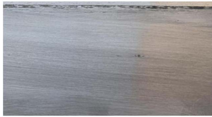
Figure 2. The serious peeling flaw 图 2. 打磨后的缺陷图
